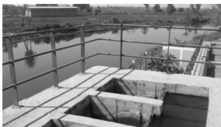
De drinkwaterzuiveringsinstallatie in Beni Ghanni ligt aan het Jozefkanaal, dat volgens de overlevering is aangelegd op bevel van Jozef toen hij onderkoning was.
